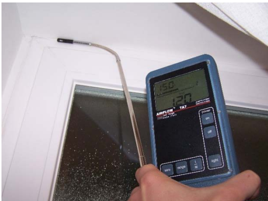
Figura 6 finestra del soggiorno – infiltrazione modesta
