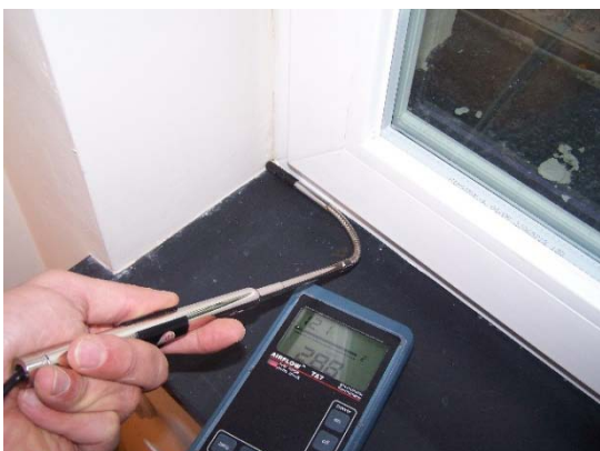
Figura 8 finestra soggiorno - infiltrazione di aria
