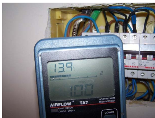
Figura 5 Quadro generale ingresso d'aria dal corrugato superiore
