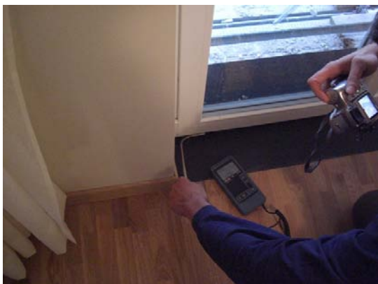
Figura 10 camera da letto - infiltrazione
